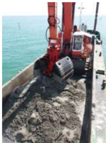
Figura 10 – Sistema di carico su tramoggia a tenuta stagna
