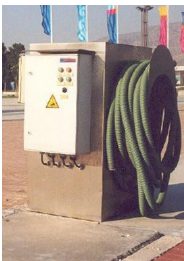
Figura 21 Colonnina per scarico reflui
